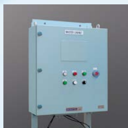
制御装置・流量調整ユニット
