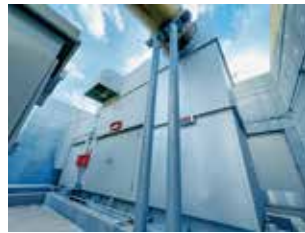
非常用ガスタービン
